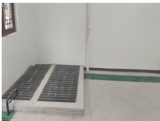
危险废物暂存间废水收集池
