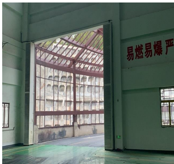
卸料大厅空气幕帘
