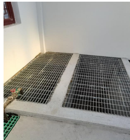
飞灰固化块暂存间废水收集设施
