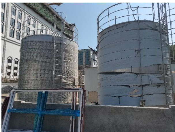
氨水罐区围堰
