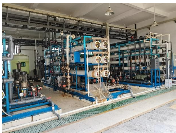
一期工程渗滤液处理系统膜车间
