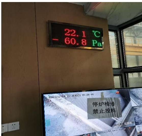
卸料大厅负压装置
